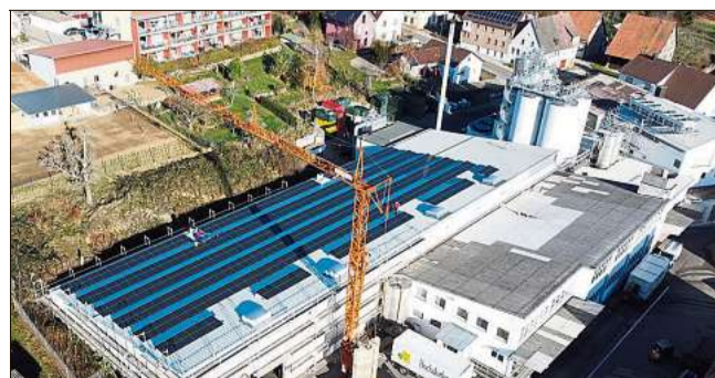
298 Module wurden bei der Photovoltaikanlage der Hochdorfer Kronenbrauerei verbaut. Sie sollen den für die Produktion anfallenden Strombedarf zu 20 Prozent decken. Foto: Katz
